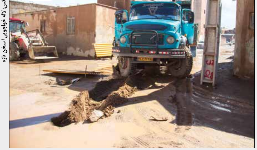
نشست زمین به علت بارندگی پس از اتمام حفاری فاضلاب
